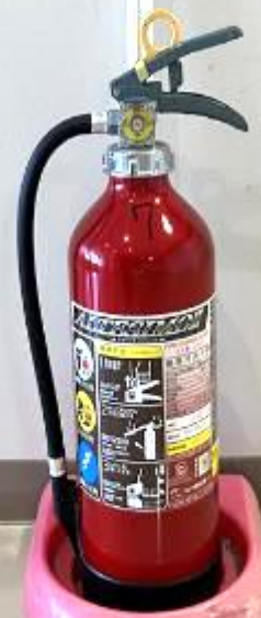
校内に設置されている消火器
